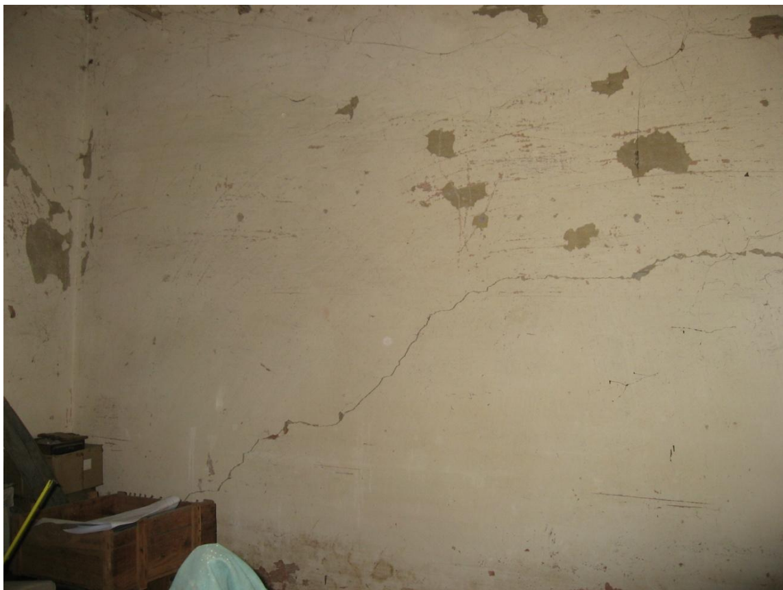
Fi 4: vista dall'altra stanza lesione ad andamento sub orizzontale nel maschio
