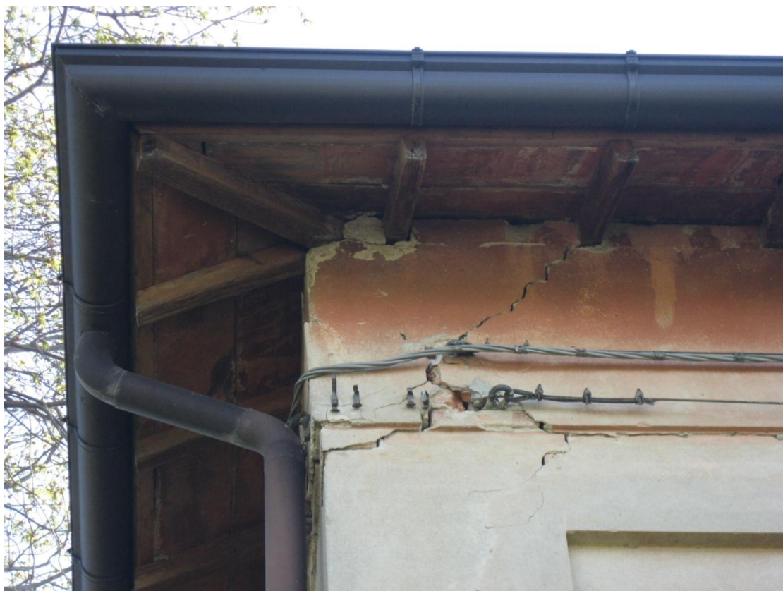
Fe 24: formazione di cuneo dislocato tra le due pareti in angolo
