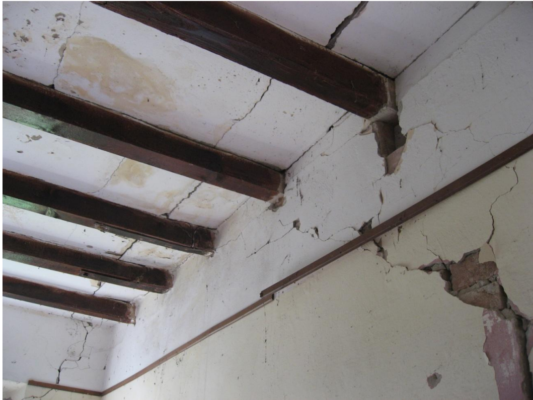
Fi 2 su muro B vista dalla stanza: lesione diagonale diffusa su maschio con sfilamento dei travetti e rottura del solaio
