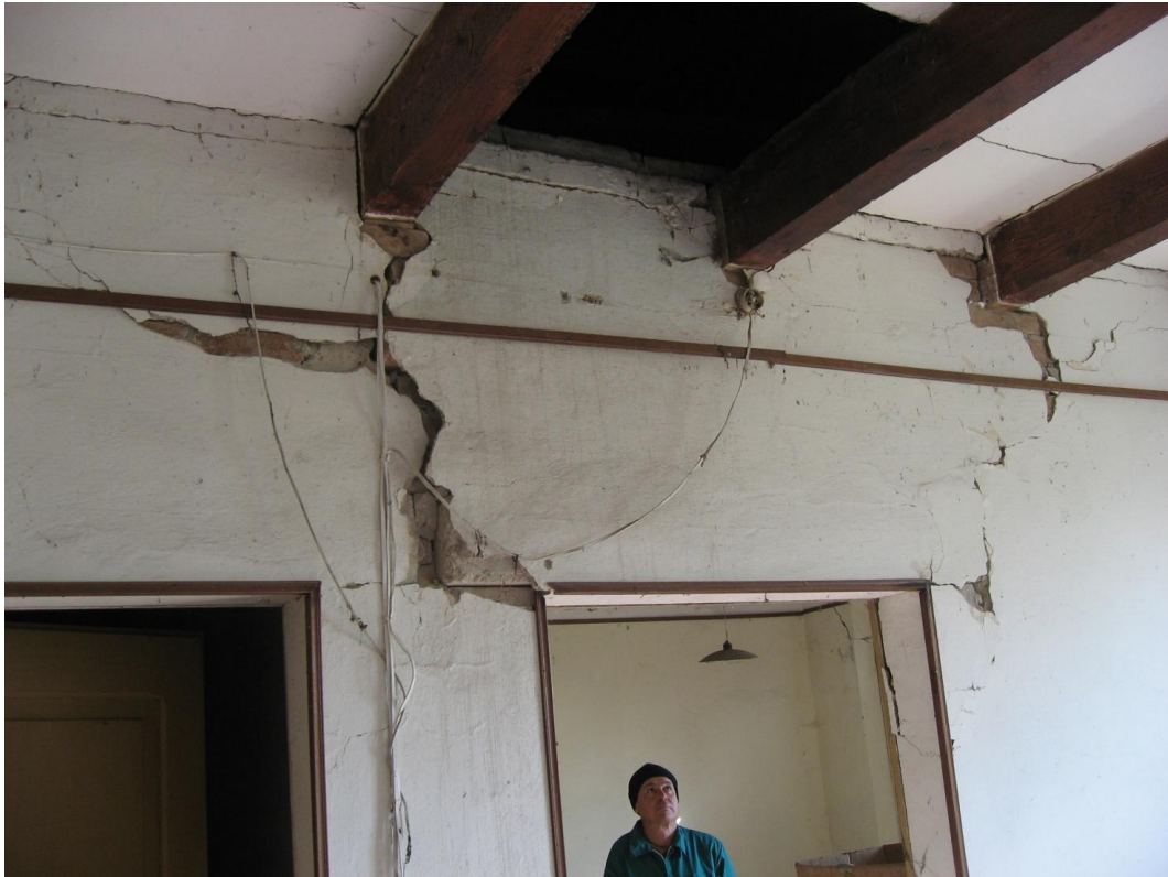
Fi 1 Fi 2 su muro B viste dal vano scale: lesione diagonale nel maschio con dislocamento dell'architrave
