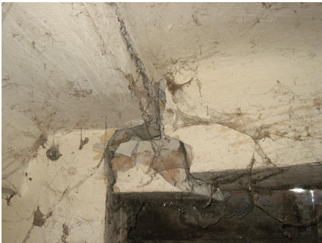
Fe 19: rottura architrave in corrispondenza dell'appoggio della rampa scale
