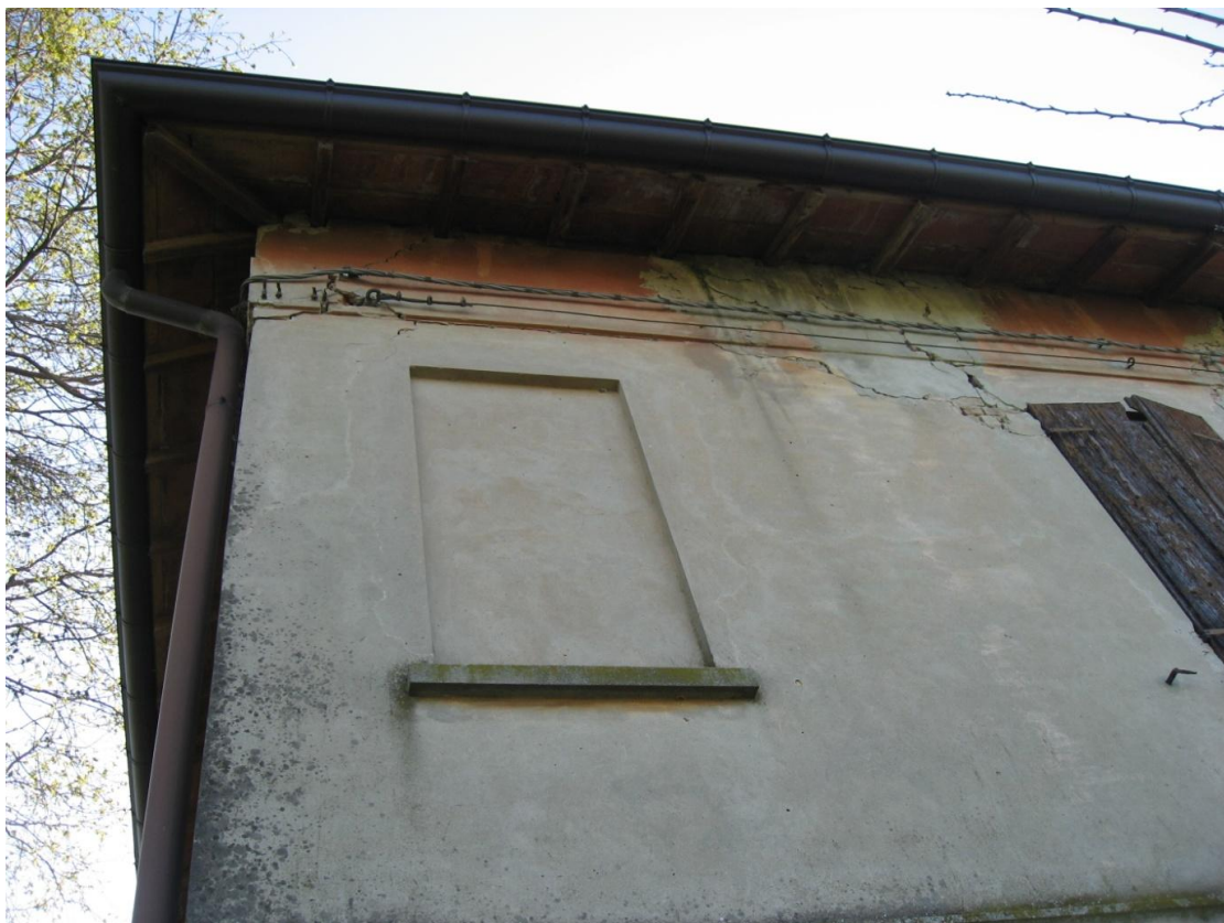
Fe 21 Fe 24 Fe 25: formazione di cuneo dislocato tra le due pareti in angolo
