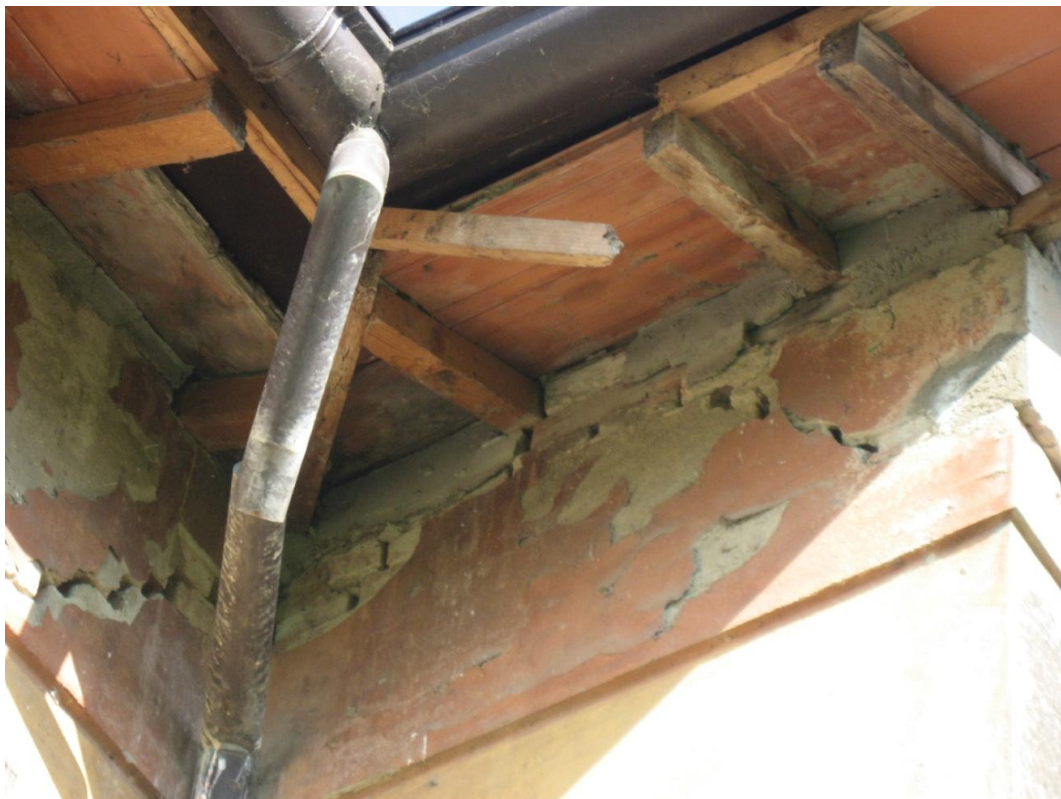
Fe 5 Fe 11: lesioni nei maschi e formazione di cuneo dislocato all'intersezione fra le due pareti in angolo, con crollo di una parte del cornicione
