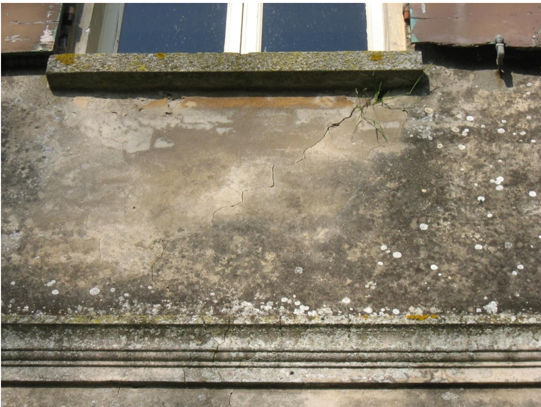
Fe 28: lesione diagonale nella fascia di piano
