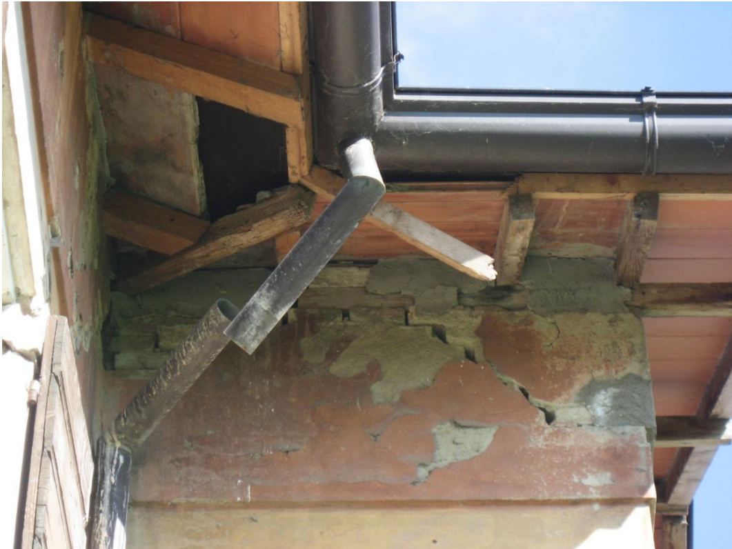
Fe 5: formazione di cuneo dislocato all'intersezione fra le due pareti in angolo, con crollo di una parte del cornicione
