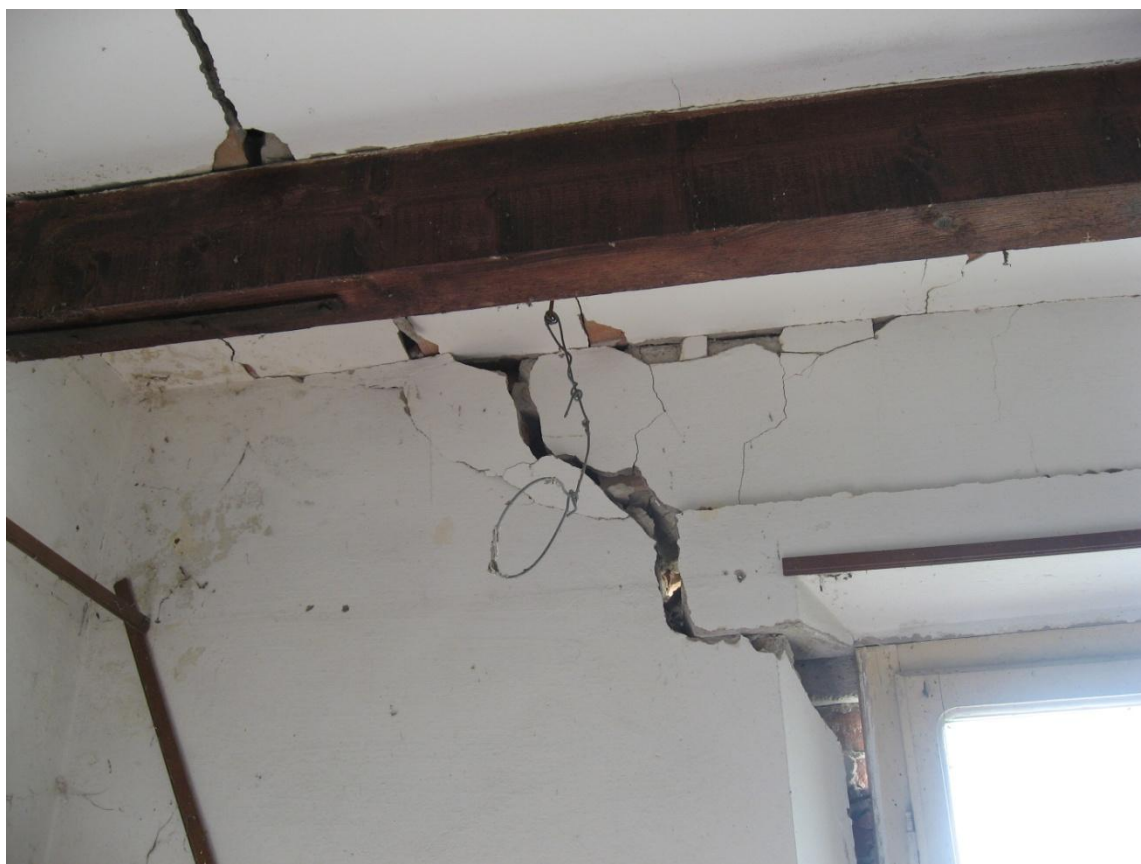
Fe 10 particolare: lesione diagonale con perdita di appoggio dell'architrave e lesione nel solaio
