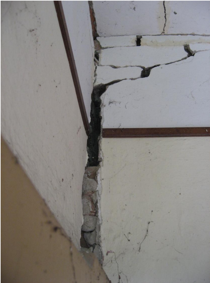
Fi 1: particolare della foto precedente con distacco tra i maschi
