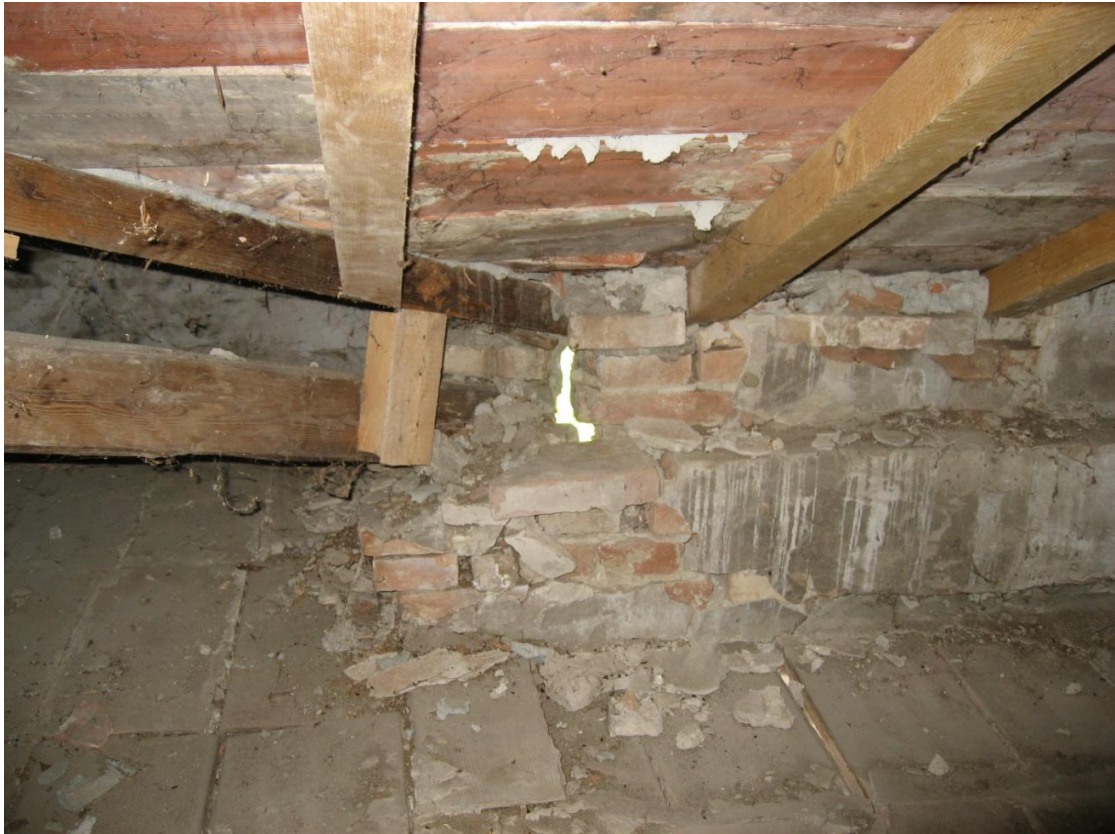
Fe 11:lesione nel maschio con perdita di appoggio del trave cantonile per spinta dello stesso sul muro
