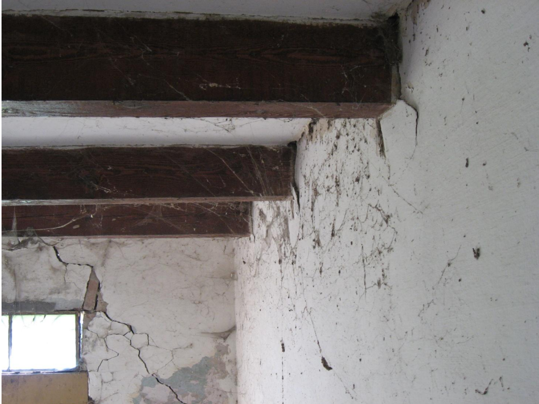
Fe 7 Fe 8: lesione diagonale nel maschio con rottura della piattabanda e sfilamento dei travetti
