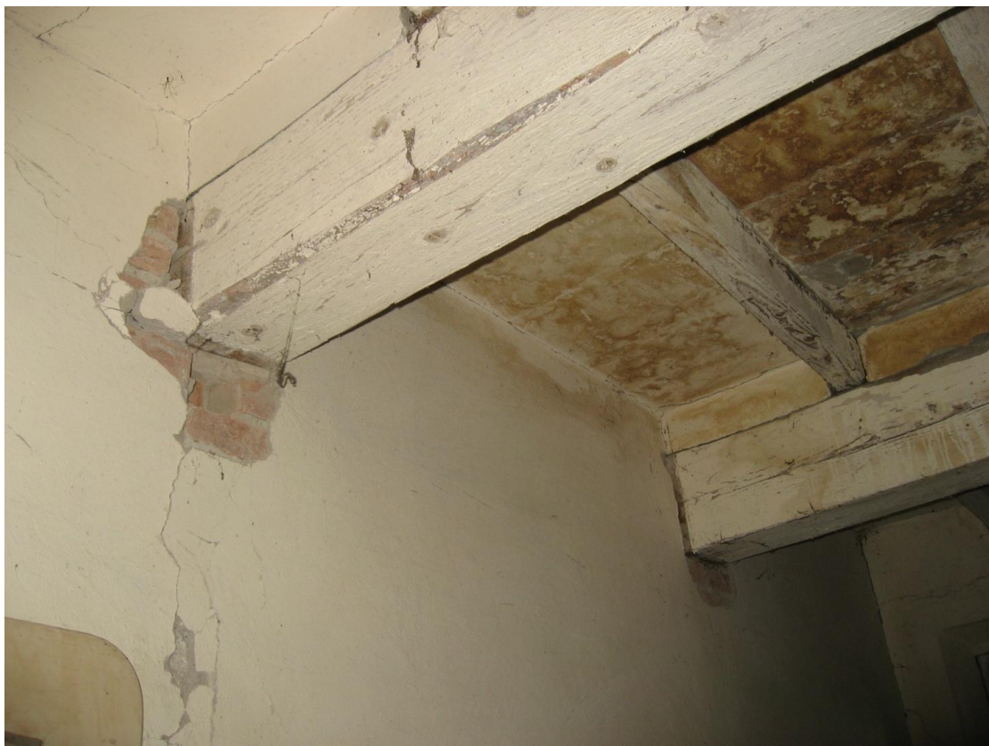
Fi 3: espulsione di materiale per martellamento delle travi, con marcato sfilamento dall'appoggio
