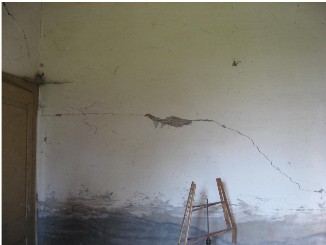
Fi 4: lesione ad andamento sub orizzontale nel maschio
