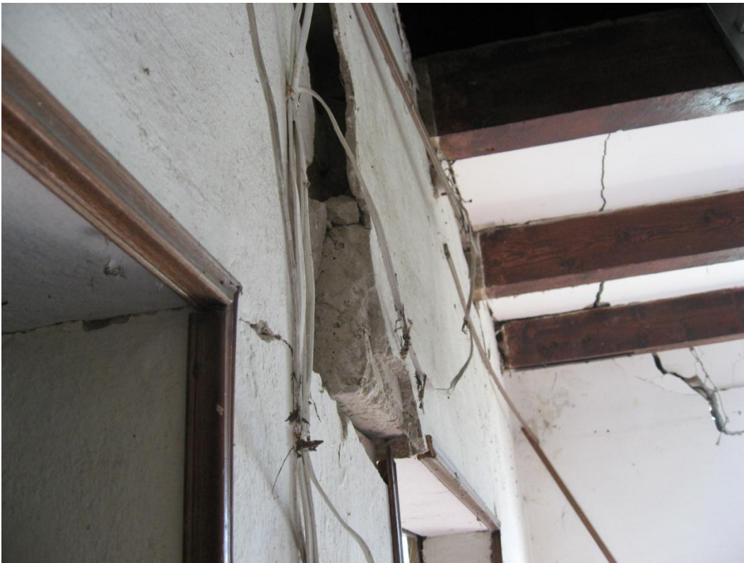
Fi 1: particolare del dislocamento dell'architrave visto dal vano scale
