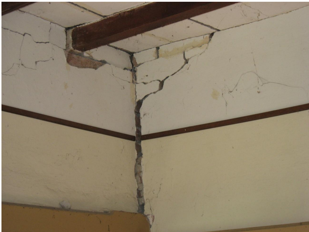
Fi 1 al martello tra muro A e muro B vista dalla stanza: lesione verticale passante all'incrocio tra maschi
