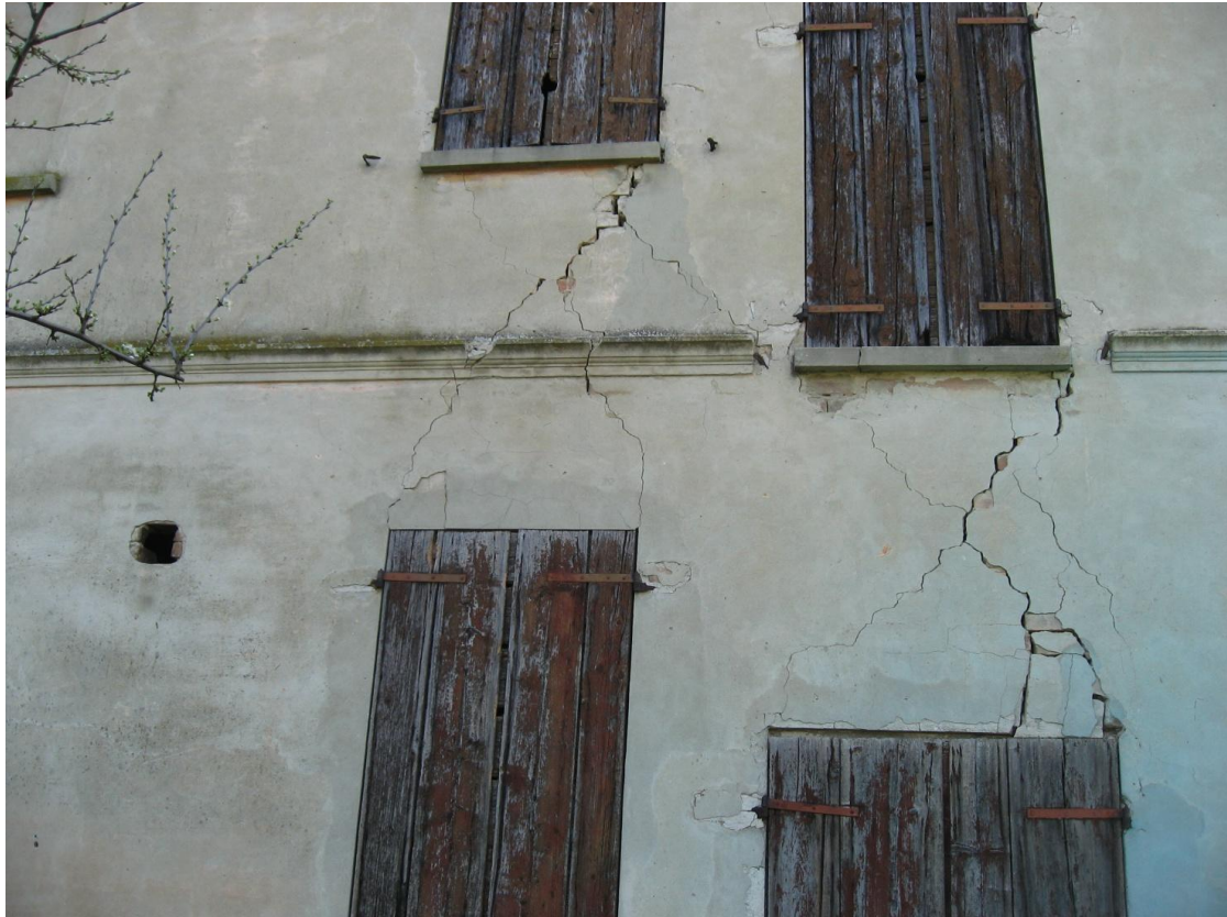
Fe 18 Fe 19 Fe 20: lesioni diagonali nelle fasce di piano e nei maschi
