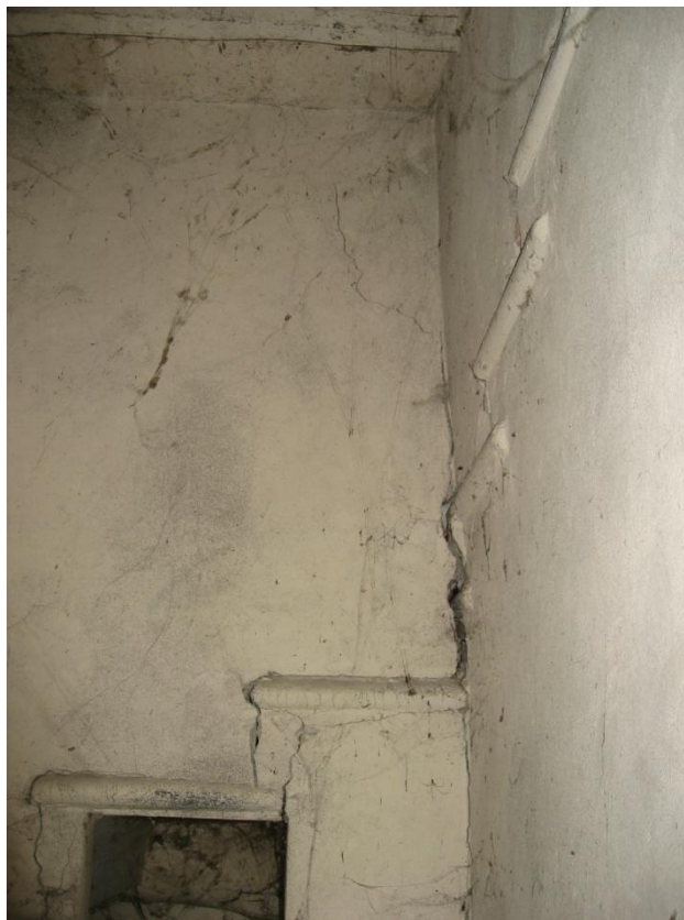
Fi 10: stessa lesione vista dall'interno del vano scale: si nota come i gradini poggiano su queste pareti in tavelle di 6 cm.
