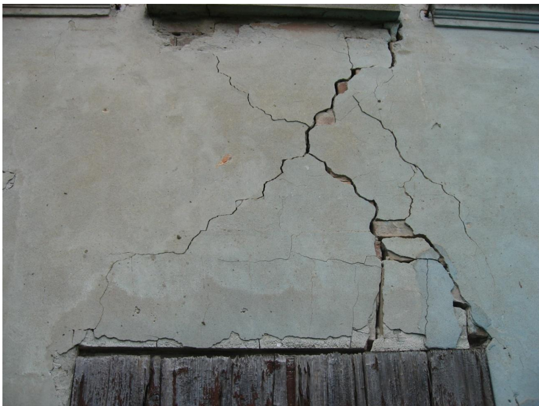
Fe 19: lesione nella fascia con rottura della piattabanda
