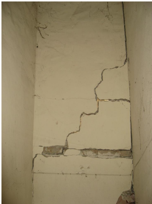
Fi 5: vista dalle scale; lesione diagonale su parete in forati da 8 cm.
