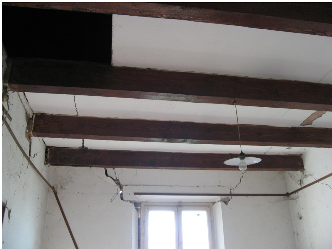
Fe 10: lesione diagonale con perdita di appoggio dell'architrave, lesione nel solaio e sfilamento dei travetti
