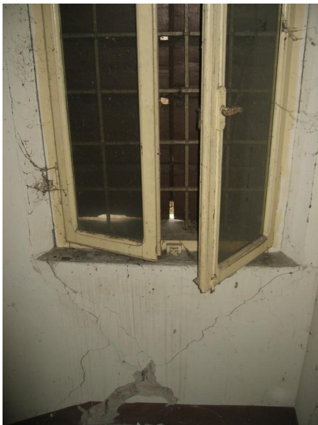
Fe 19: lesione diagonale nella fascia sottofinestra
