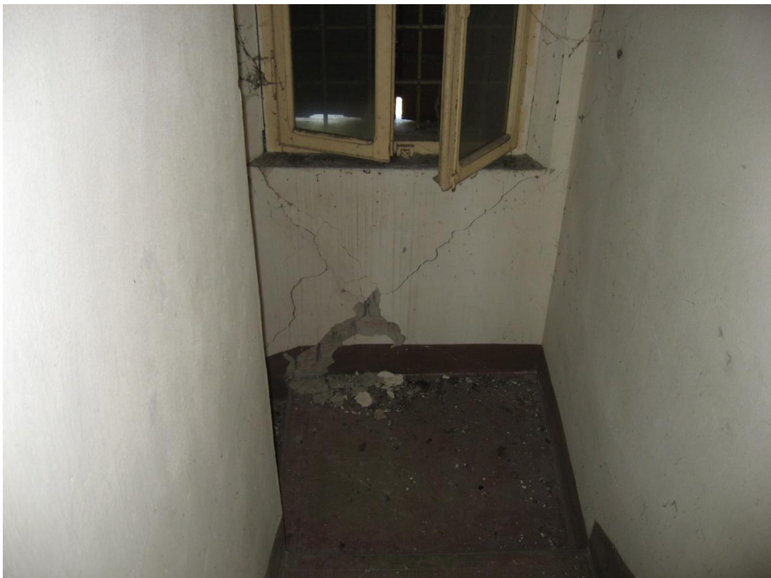
Fe 19: lesione diagonale nella fascia sottofinestra
