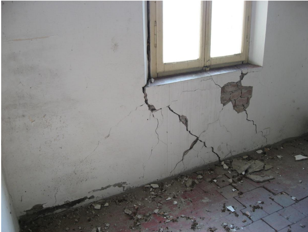
Fe 9:lesione diagonale nella fascia sottofinestra
