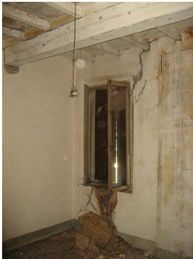
Fe 20 Fe 21: lesioni diagonali nel maschio e nella fascia sottofinestra
