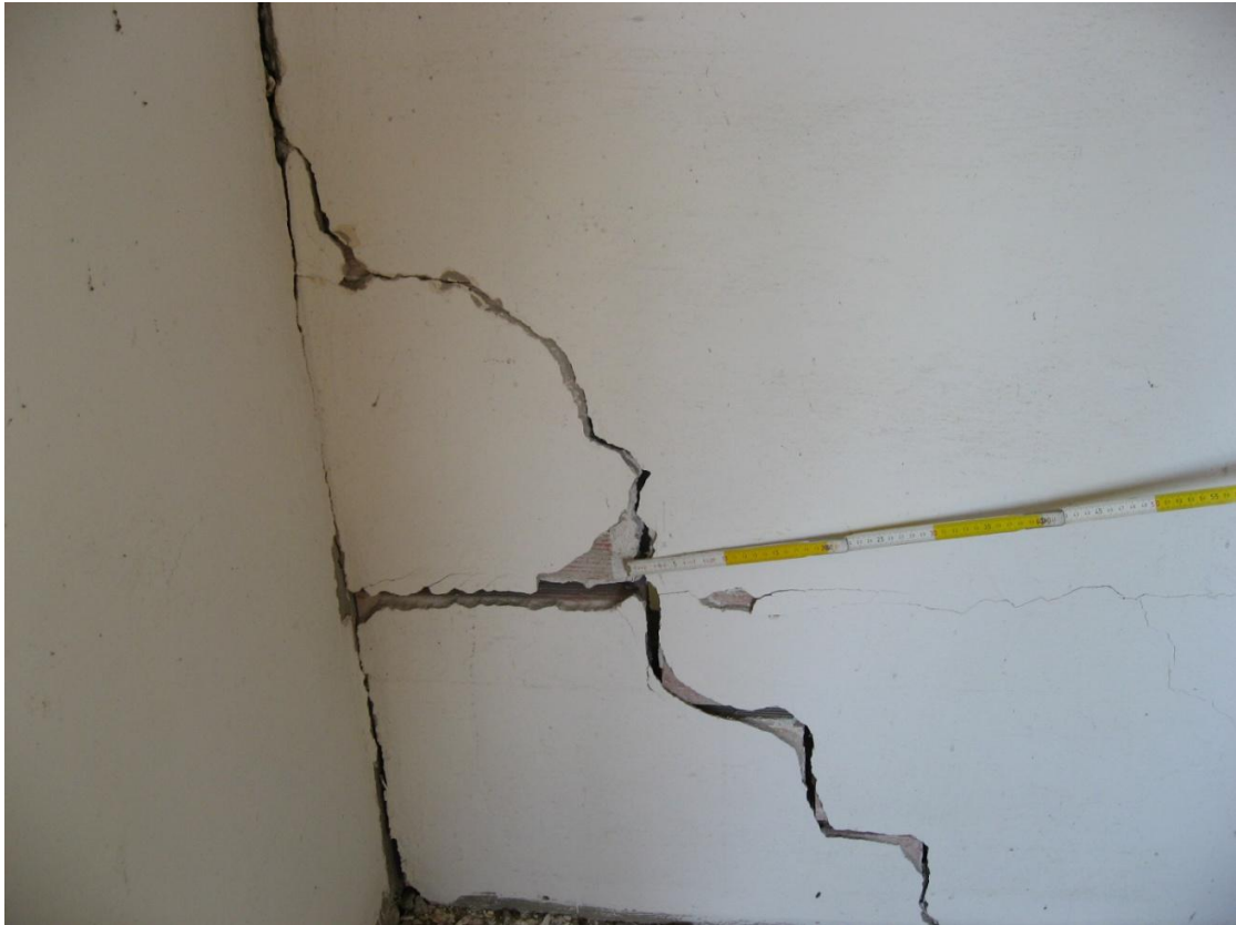
Fi 5: lesione diagonale su parete in forati da 8 cm.
