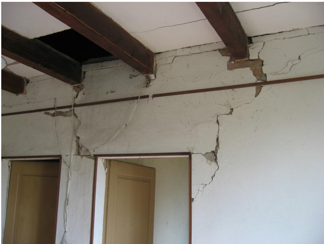
Fi 1 Fi 2 su muro B viste dal vano scale: lesioni diagonali nei maschi e sfilamento dei travetti
