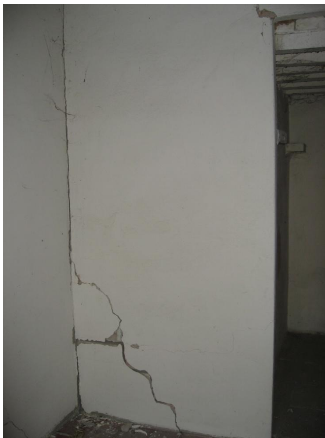
Fi 5: lesione diagonale su parete in forati da 8 cm.
