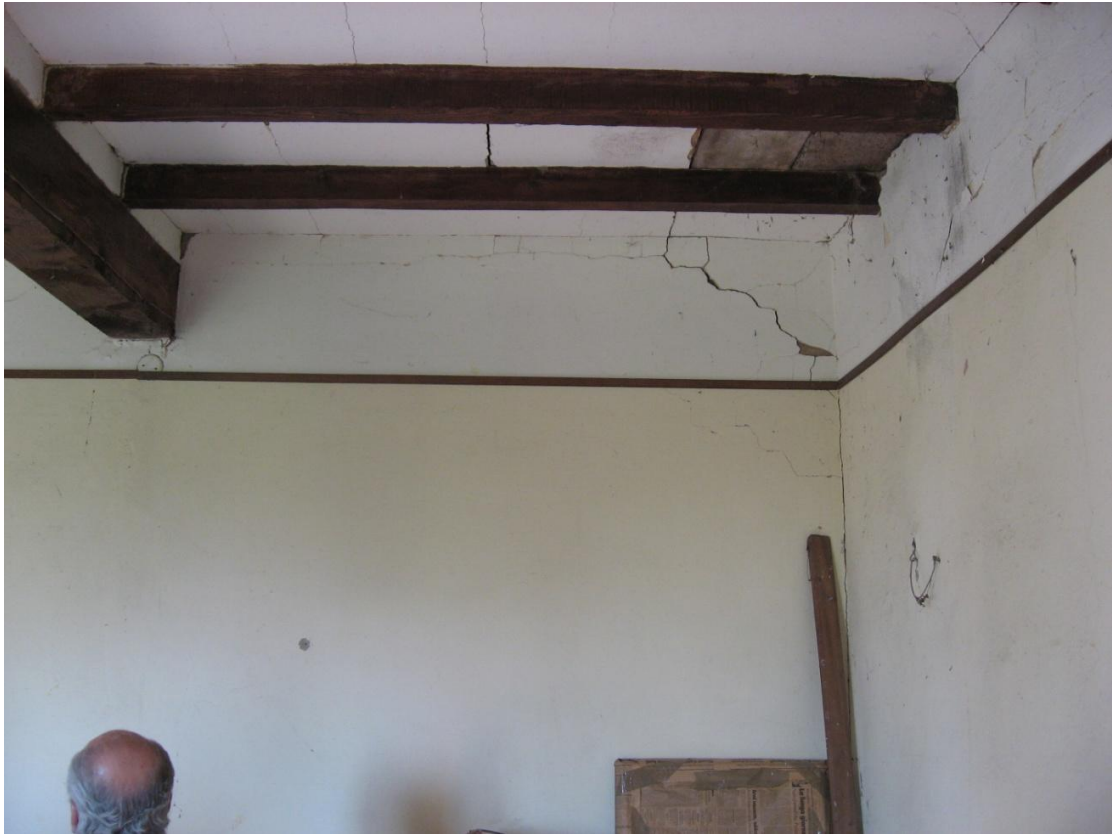
Fi 9: lesione diagonale nel maschio e lesione del solaio
