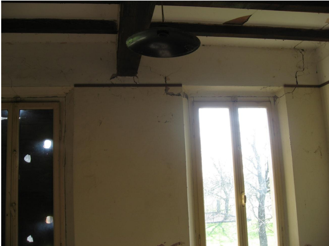
Fe 27 Fe 28: lesione diagonale nei maschi e martellamento della trave
