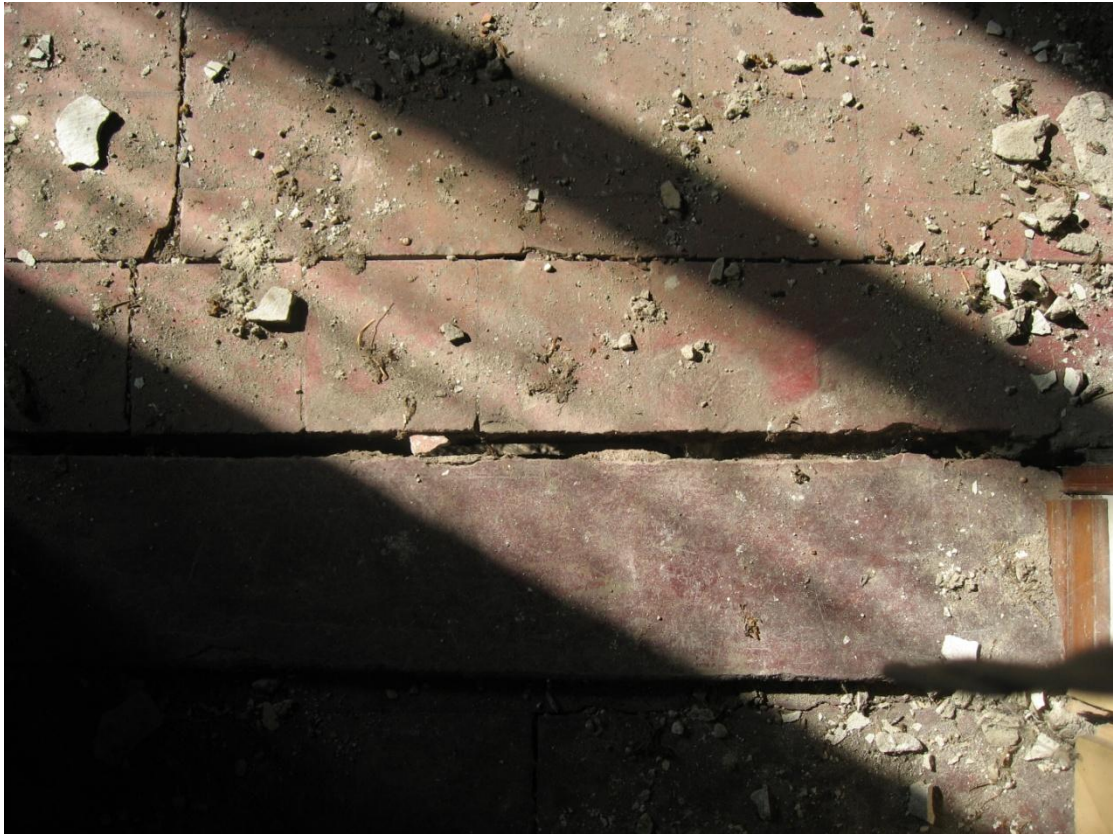
Distacco del pavimento a 1° piano per sfilamento dei travetti sottostanti
