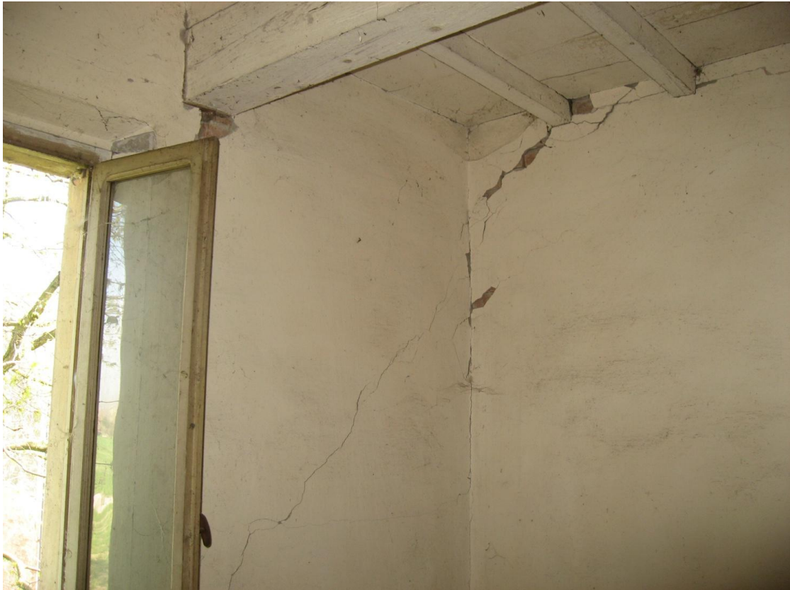
Fe 30 Fe 31 Fi 9: lesioni diagonali nei maschi
