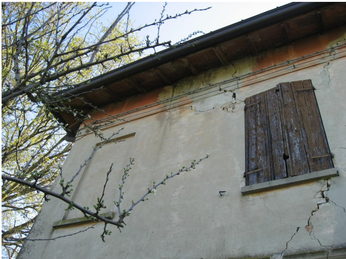
Fe 20 Fe 21 Fe 22 Fe 25 Fe 26: lesioni diagonali nella fascia e nei maschi
