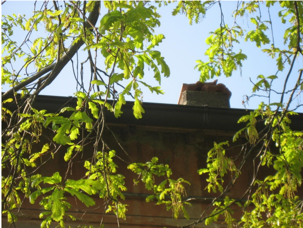
Crollo parziale del comignolo sul fronte nord
