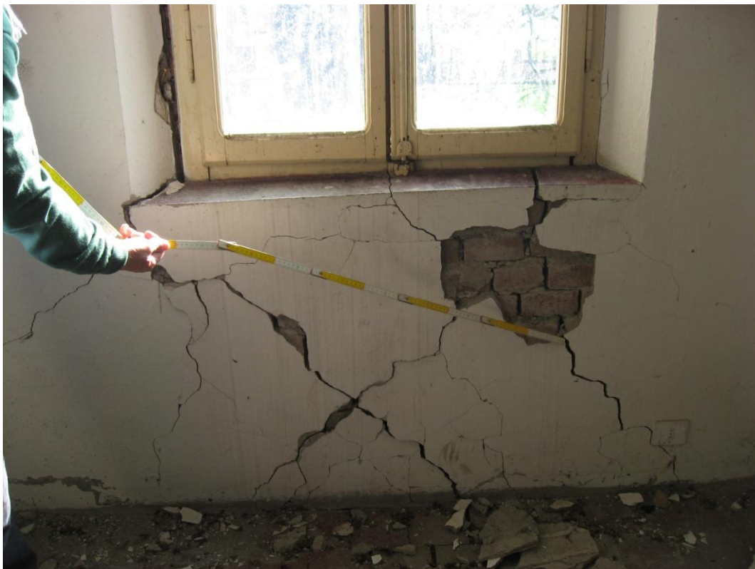
Fe 9: lesione diagonale nella fascia sottofinestra
