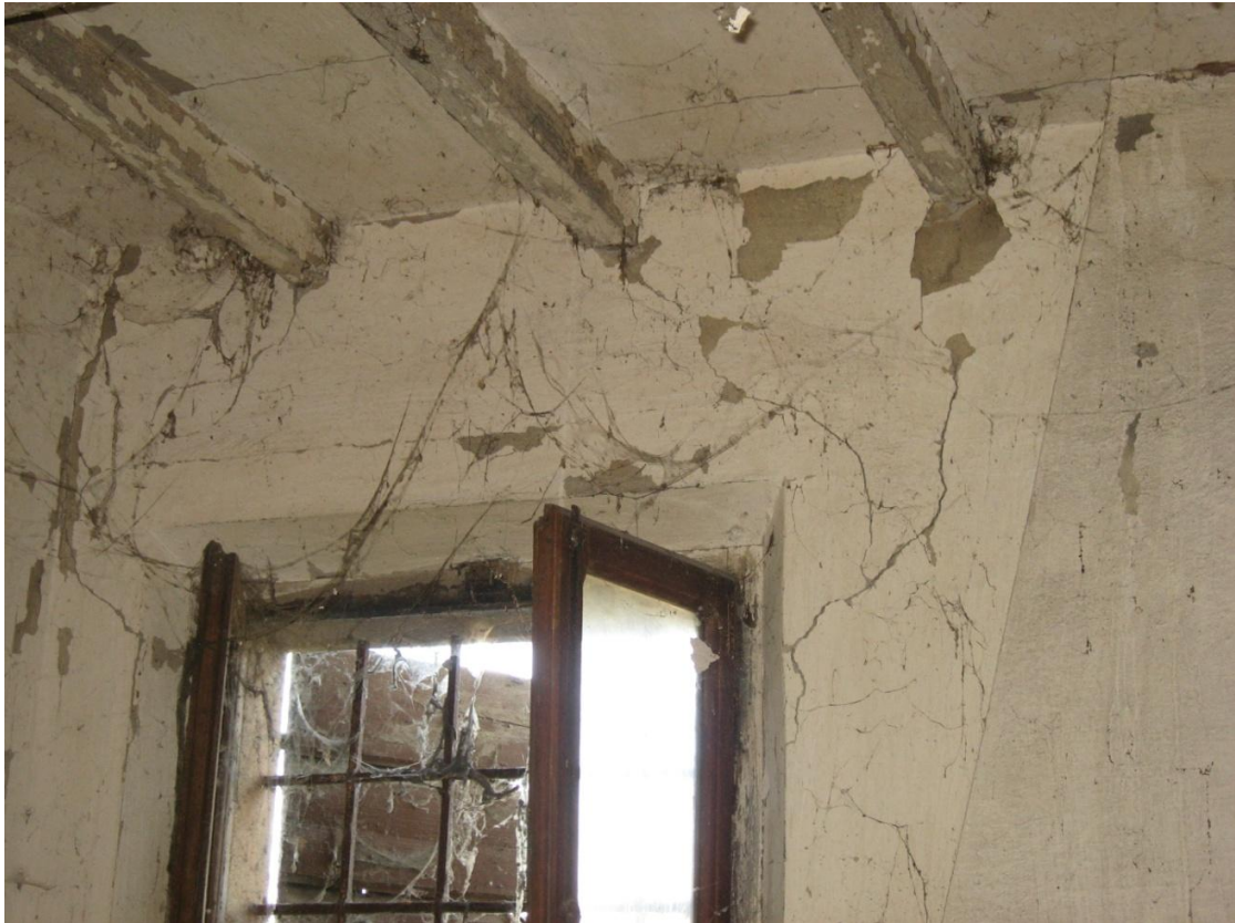
Fe 18: lesione diagonale nella fascia soprafinestra
